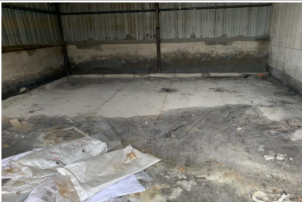
危废库房 2 地面现状
