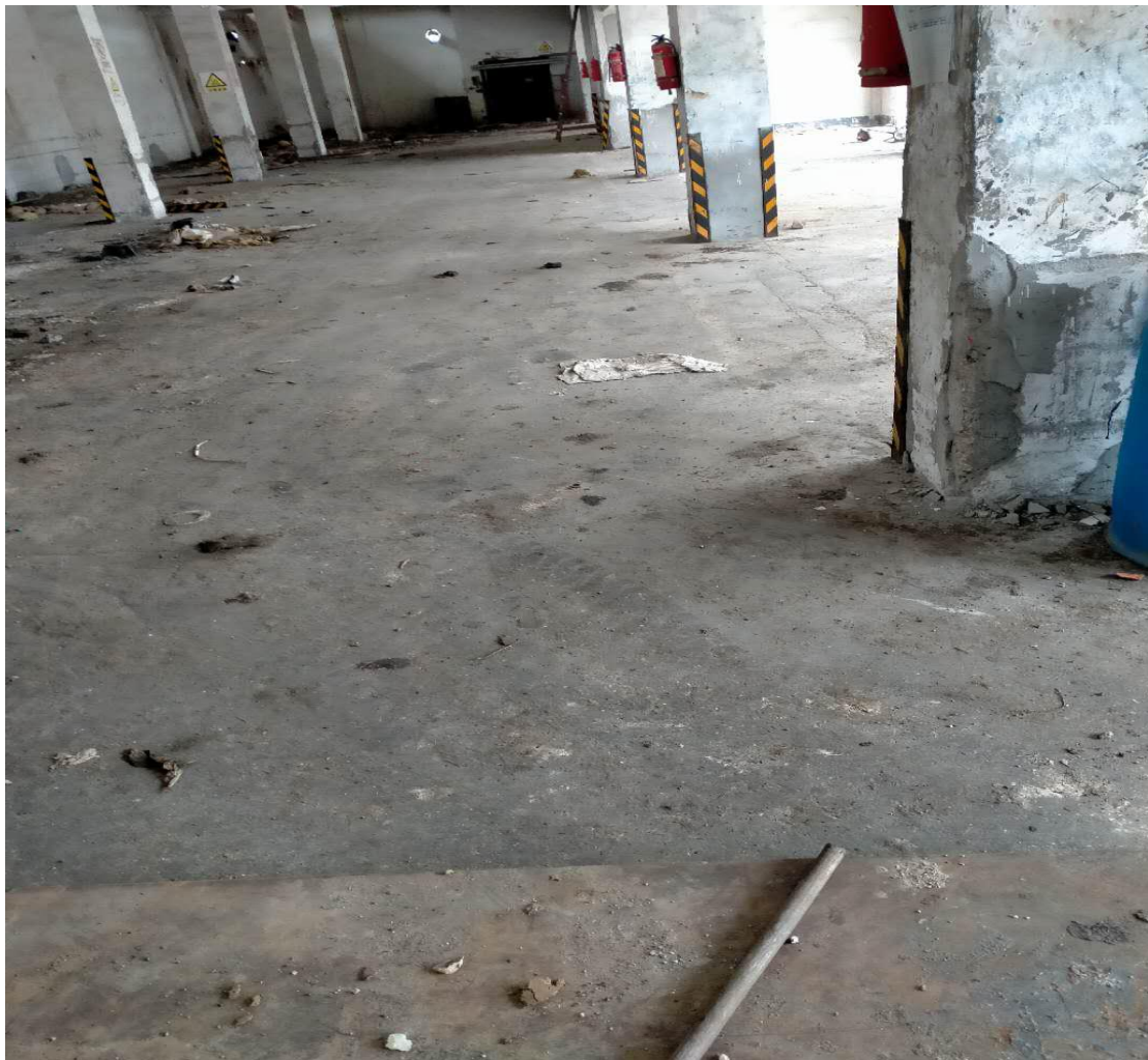
图 3.5-1 生产车间地面污染痕迹
