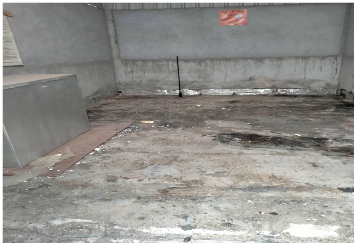
危废库房 1 地面现状
